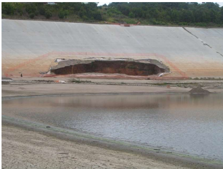
Figura 23. Fallo de lámina de PVC por colapso de la galería del dique de cierre
