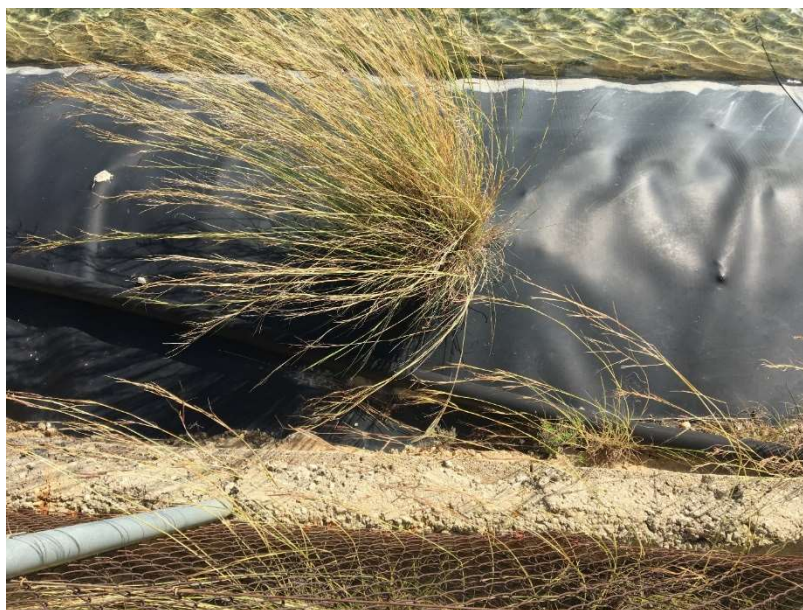
Figura 49. Vegetación creciendo en el interior de una grieta en una geomembrana de PEAD
