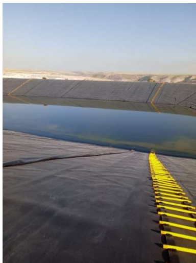
Figura 52. Lastres en taludes y escalas de salvamento
