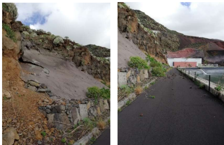
Figura 54. Desprendimientos del talud sobre el camino de coronación
