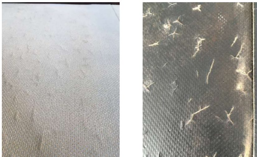
Figura 43. Roturas tipo estrella a causa de impactos en una lámina de PVC armada sobre la cara anterior (izquierda) y posterior (derecha)
