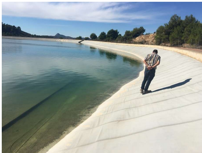
Figura 47. Deformación de taludes por acción del oleaje bajo geomembrana de PVC-P
