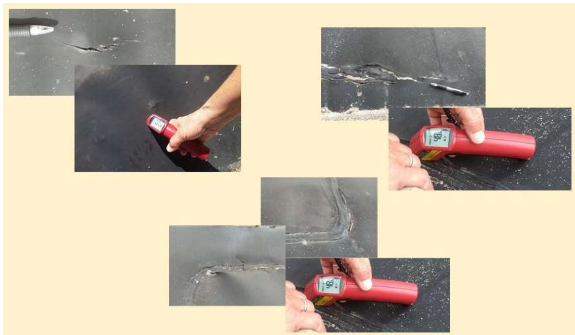
Figura 8. Agrietamiento por esfuerzos medioambientales (stress-cracking) detectado en diferentes puntos de una geomembrana de PEAD
