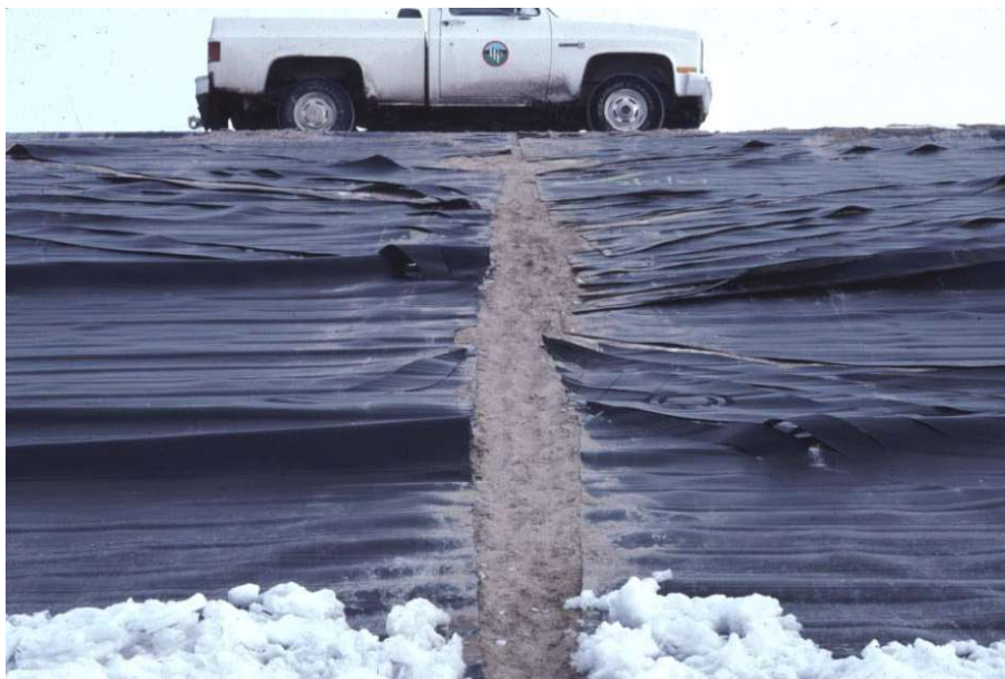
Figura 40. Rotura en lámina de PEAD por retracción debido a bajas temperaturas. Este fenómeno se conoce como rotura frágil y, en este caso, se observa como el soporte de la balsa queda al descubierto
