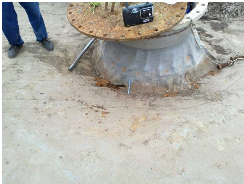
Figura 25. Rotura en lámina de PVC como consecuencia de asientos diferenciales en estructura de toma
