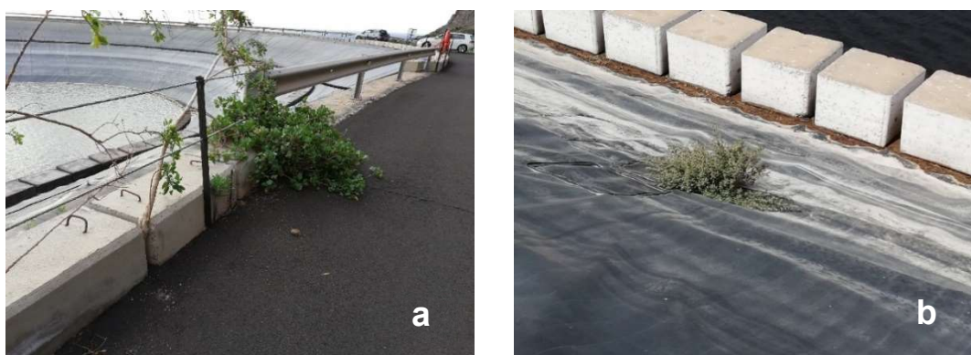
Figura 48. Vegetación en coronación (a) y en la geomembrana (b)
