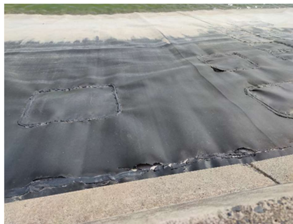
Figura 30. Grietas en el cambio de plano en la coronación
