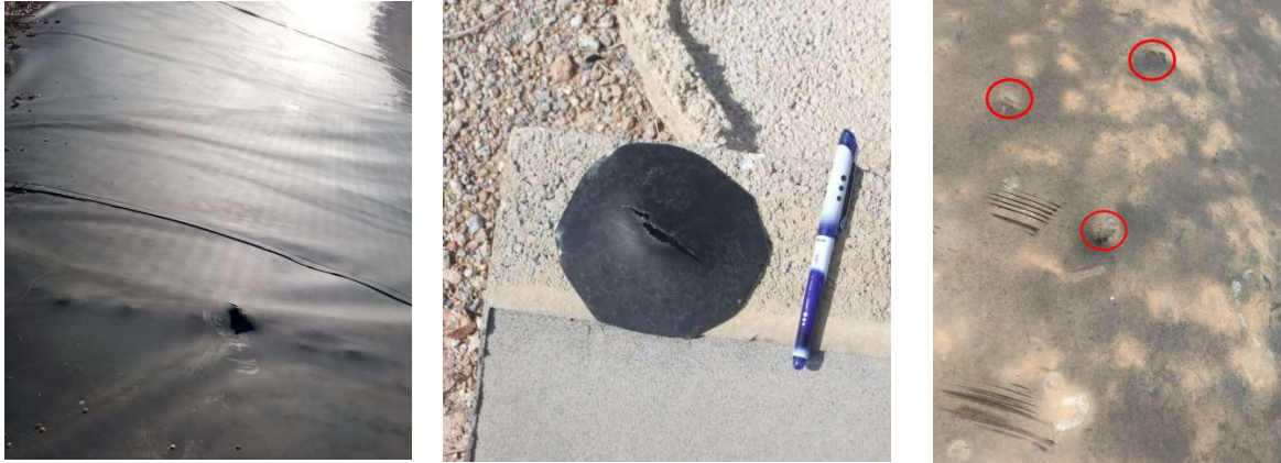
Figura 29. Punzonamiento estático por deficiente acondicionamiento del soporte
