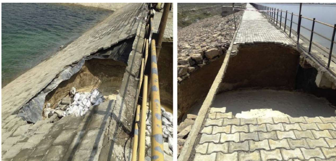
Figura 22. Fallo de una lámina de PEAD por un proceso de erosión interna del dique de cierre
