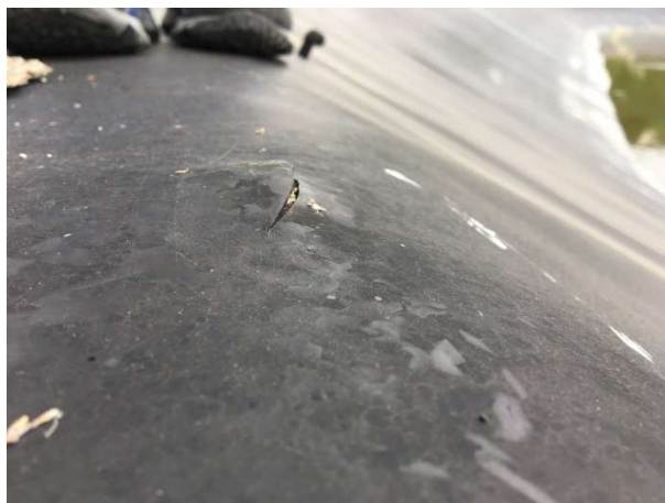
Figura 31. Punzonamientos en la esquina superior del talud (cambio de plano) en láminas de PEAD.
