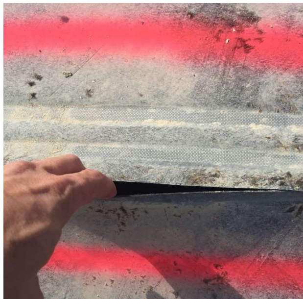
Figura 35. Desgarro en borde exterior de soldadura
