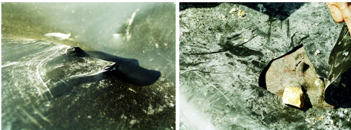
Figura 27. Plastificación (izquierda) y rotura (derecha) en lámina de PEAD por punzonamiento hidráulico debido a un canto en el soporte
