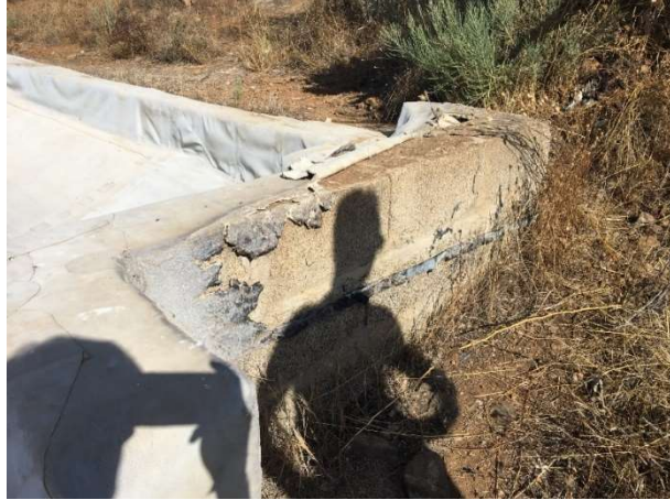
Figura 55. Lámina de PVC-P afectada por un incendio contiguo
