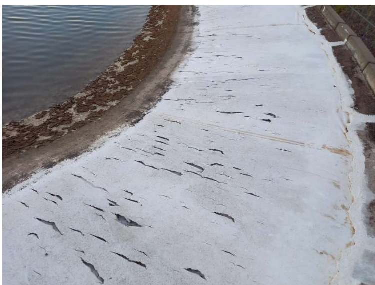
Figura 21. Roturas en láminas de PVC como consecuencia de la combinación de la retracción por pérdida de plastificante y los impactos de una tormenta de granizo.
