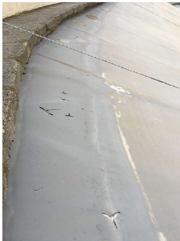
Figura 42. Roturas tipo estrella a causa de impactos en lámina de PVC homogénea.
