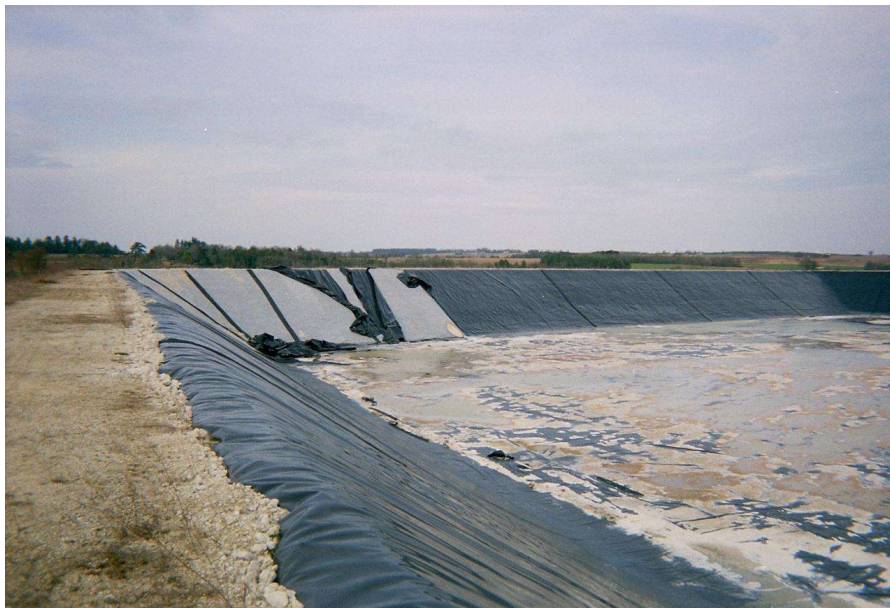
Figura 46. Lámina de PEAD arrancada por succiones de viento
