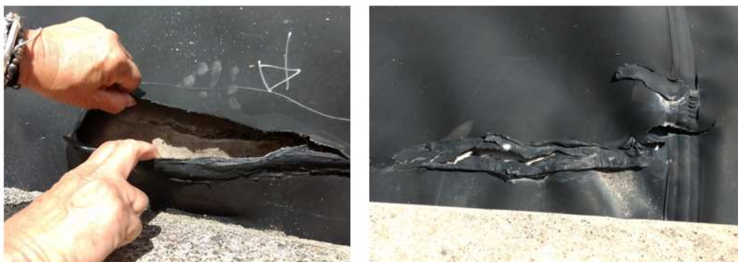
Figura 37. Desgarros en la geomembrana próxima a coronación
