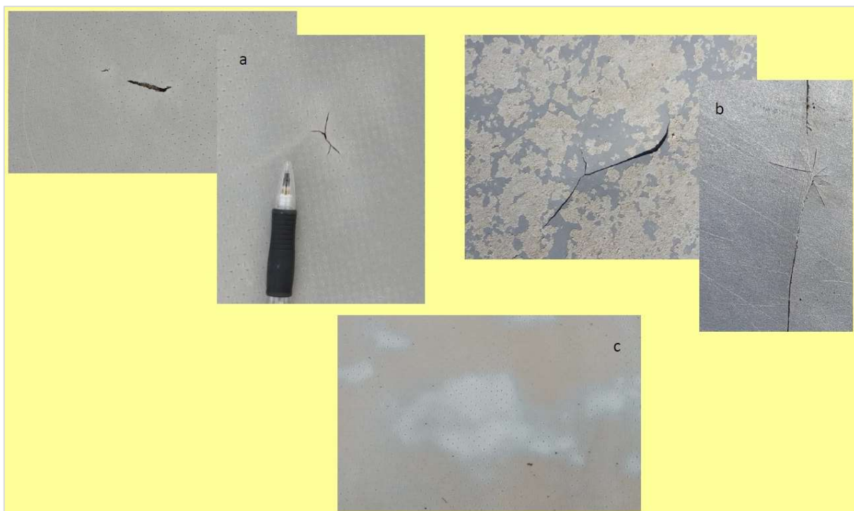
Figura 5. Tipos de degradación en una geomembrana de PVC-P: grietas por degradación del PVC (a), rotura por granizo (b), decoloración por pérdida de ácido clorhídrico (c)
