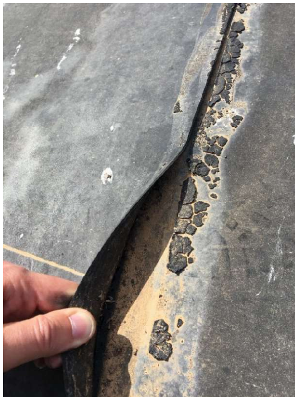
Figura 36. Defecto en unión entre paños de lámina de EPDM, fácilmente despegable con la mano
