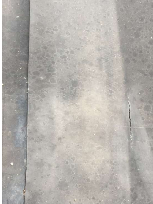
Figura 34. Desgarro en borde exterior de soldadura en lámina de PEAD
