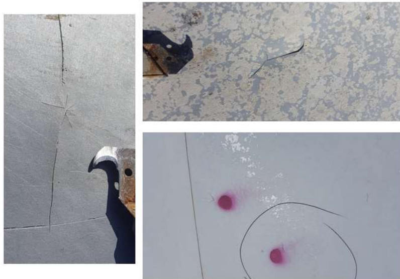
Figura 41. Efectos del granizo en la geomembrana
