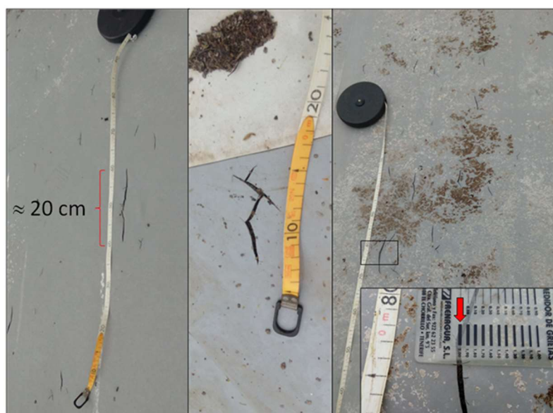
Figura 20. Paso de estalladuras a roturas/brechas de más de 10 cm en el plazo de 4 meses, llegando a alcanzar algunas casi los 20 cm de longitud y 2 mm de separación por el efecto de la retracción
