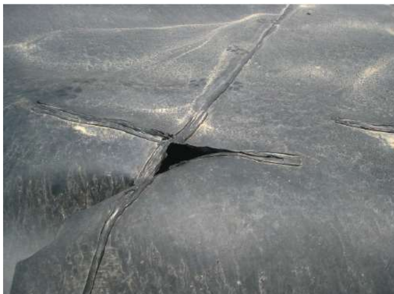
Figura 39. Fallo de soldadura de extrusión en lámina de PEAD por dilataciones térmicas
