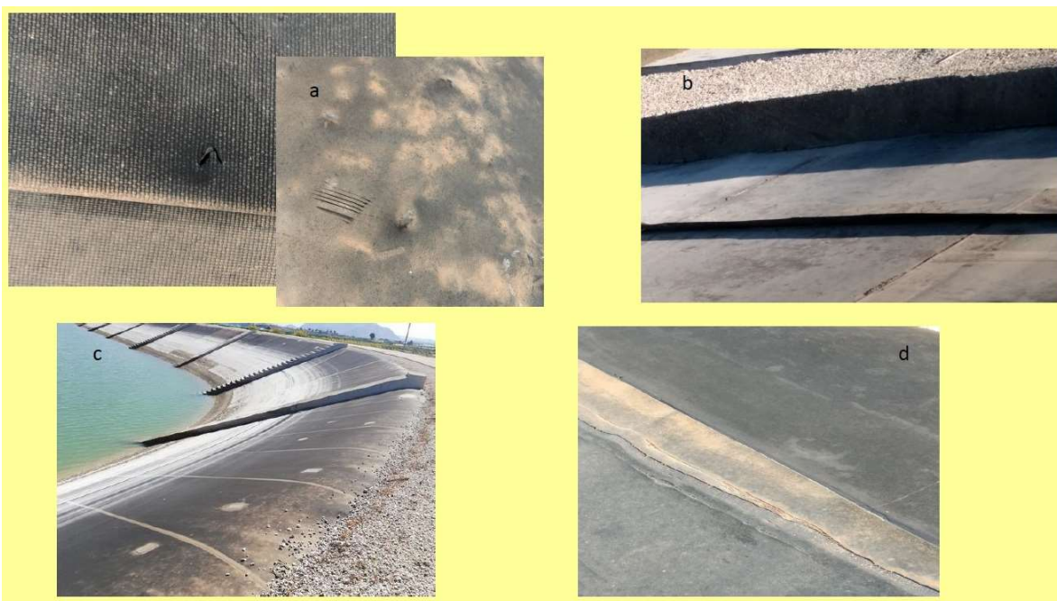
Figura 9. Detalles de la degradación de las geomembranas de EPDM: perforación por la presencia de sólidos punzantes (a), despegue de la soldadura (b), reparación de perforaciones en la coronación de la balsa (c) retracción de la geomembrana (d).
