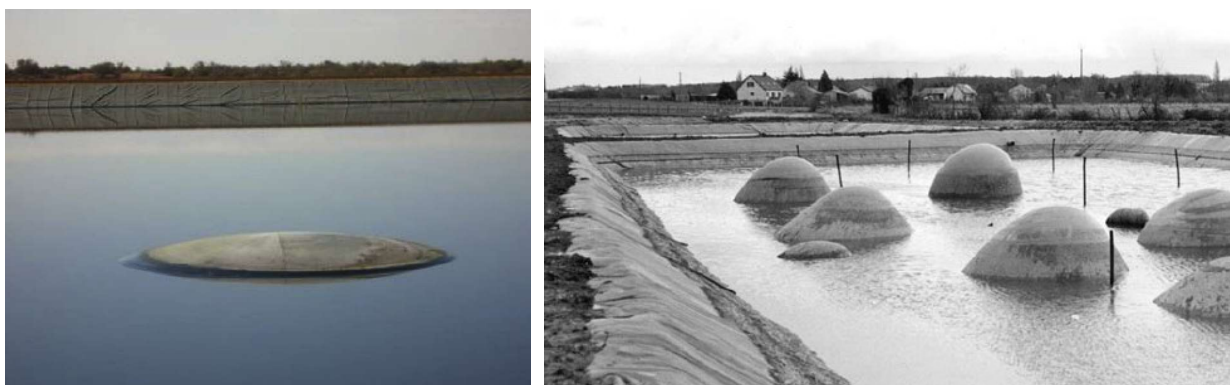
Figura 32. Formación de bolsas por efecto de gas acumulado debajo de la geomembrana
